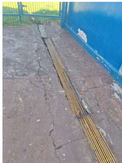
Foto: Grade quebrada
