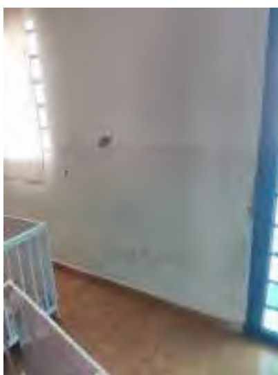
Foto: Infiltração parede Sala 1
