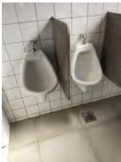
Foto: Vazamento mictório
