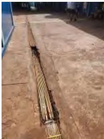
Foto: Ralo quebrado
