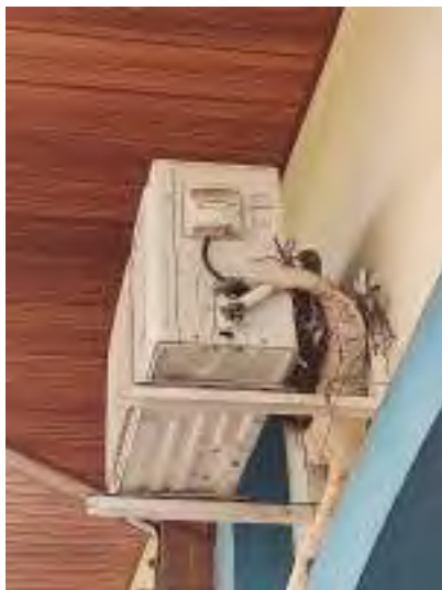
Foto: Pomba no ar-condicionado
