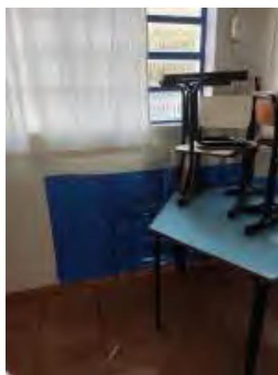
Foto: Infiltração coberta
