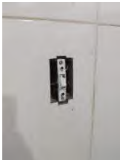
Foto: Tomada sem proteção
