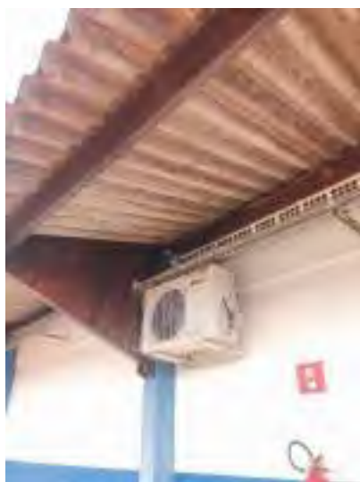
Foto: Pombo no ar-condicionado
