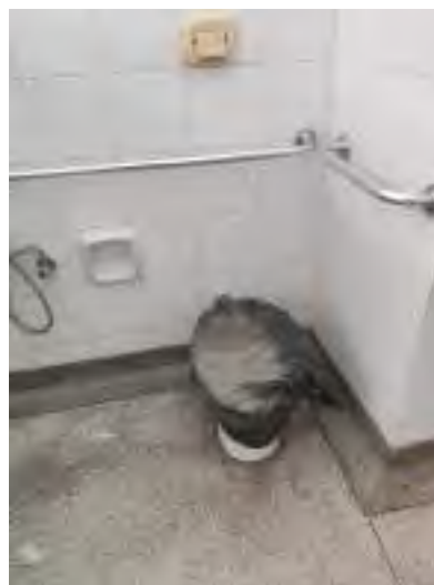
Foto: Vaso sanitário quebrado
