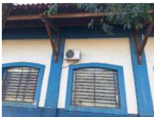
Figura: Paredes e janelas sujas
