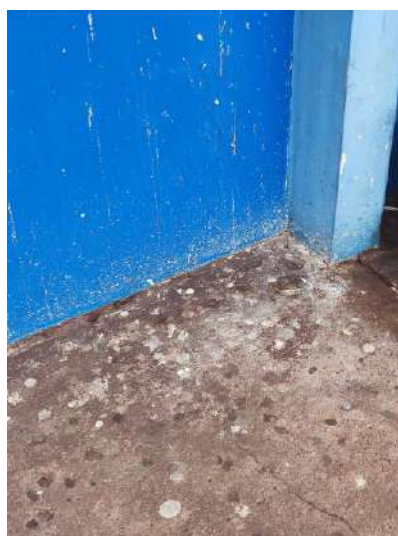
Figura: Sujeira provinda dos pombos.
