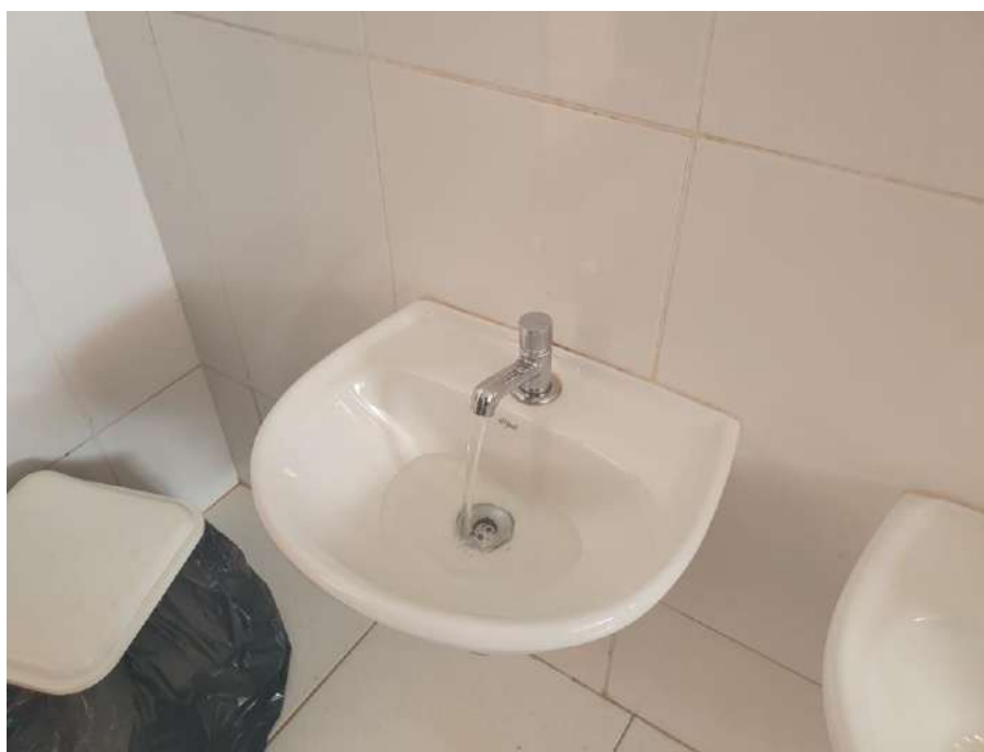
Figura: Torneira banheiro.
